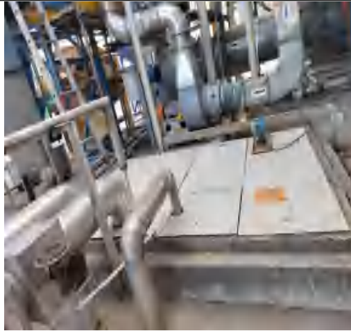
图 3-1 本项目废水池
