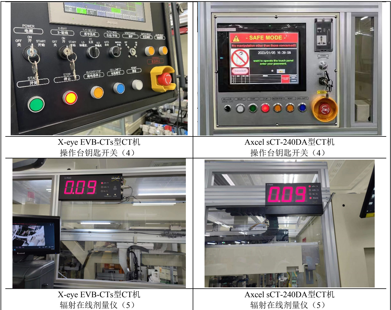
图 3-4 辐射防护安全措施情况现场图
