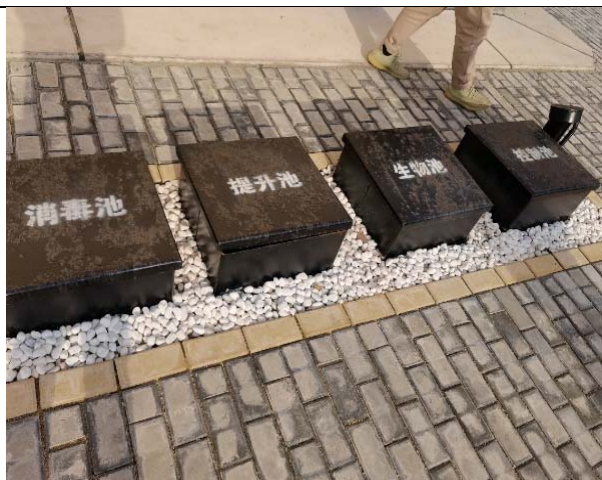
图 6.1-9 地埋式生活污水处理设施
