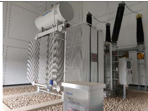
图 6.1-12 主要设备位于室内
