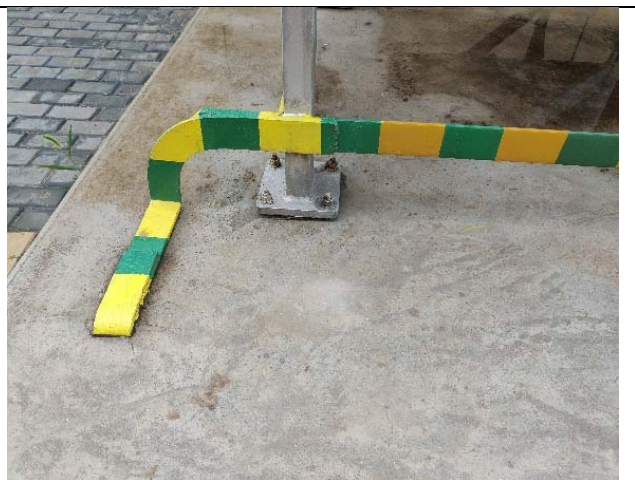
图 6.1-10 高压接地装置
