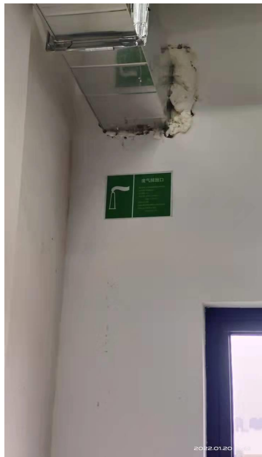
废气排口标识牌
