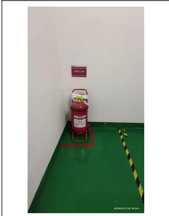
危废暂存间已放置灭火器
