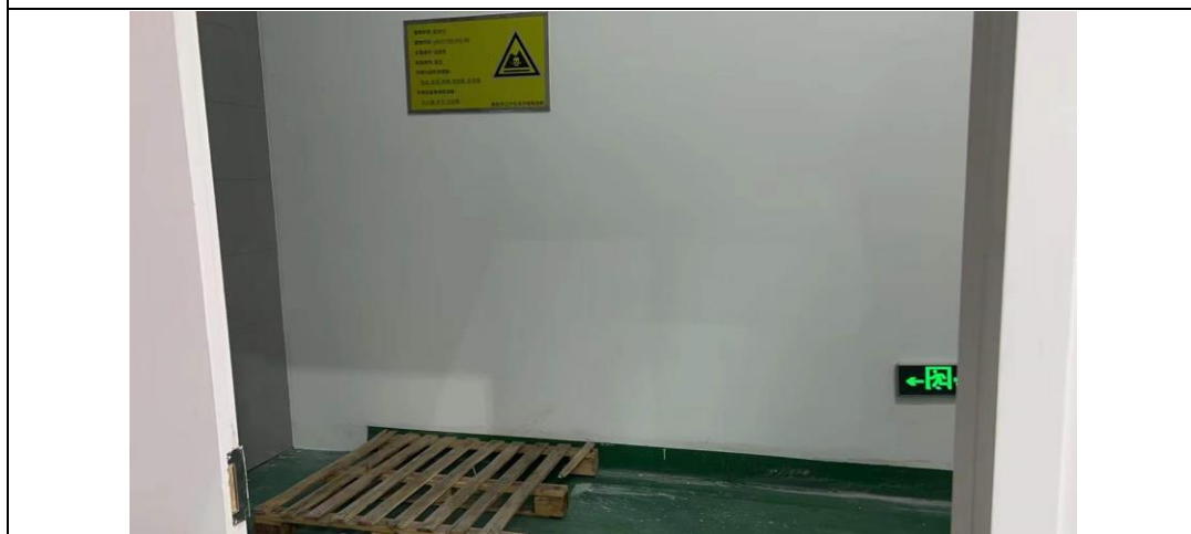
危废暂存间内部标识牌
