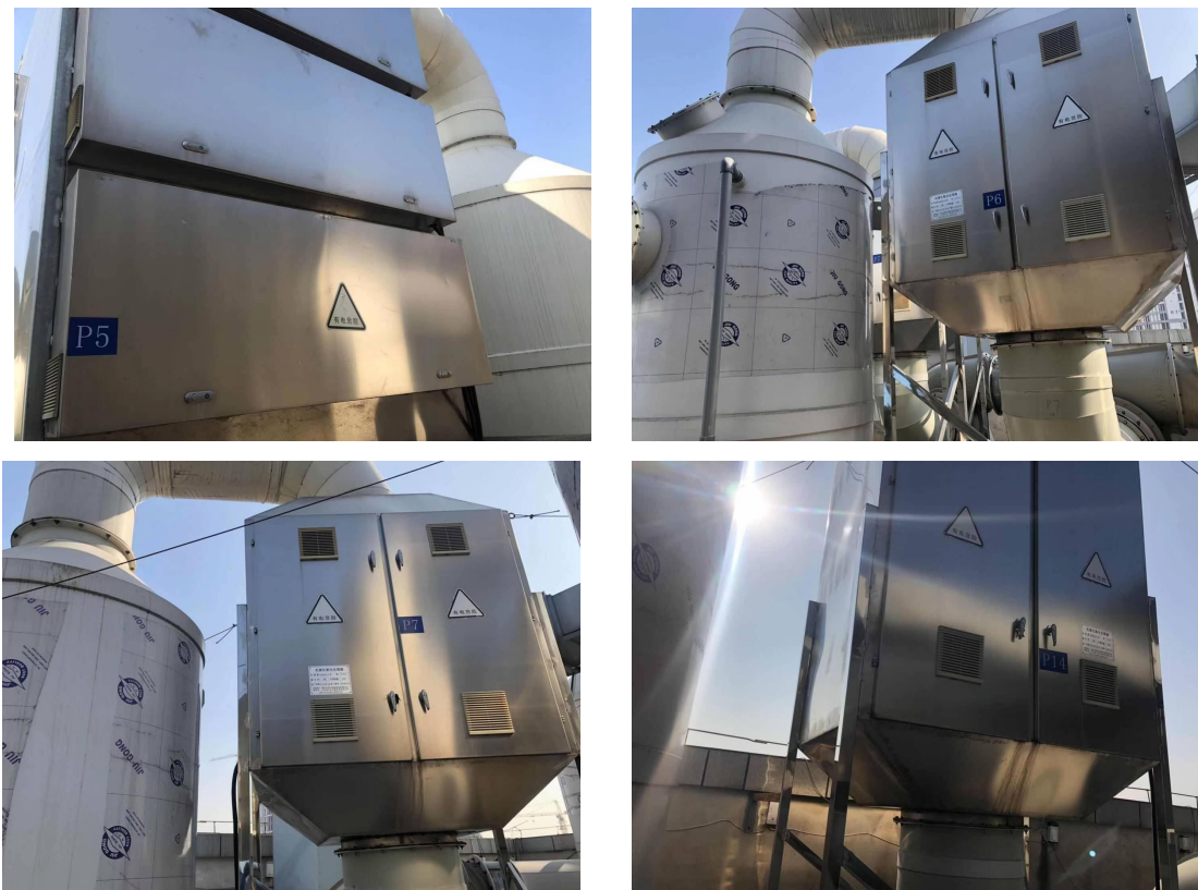
P5、P6、P7、P14 废气处理设施现场照片
