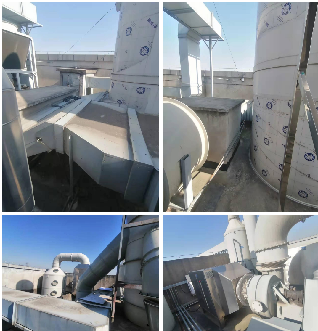
图 7-1 P5、P6、P7、P14 排气筒进口管道情况
