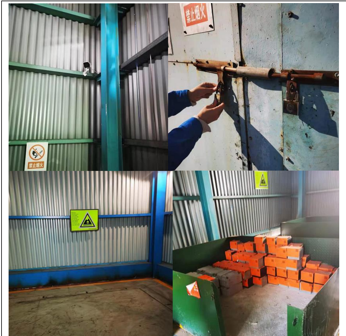
图 3-4 危险废物暂存间内部照片
