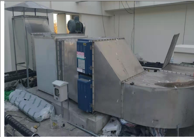
油烟净化处理设施
