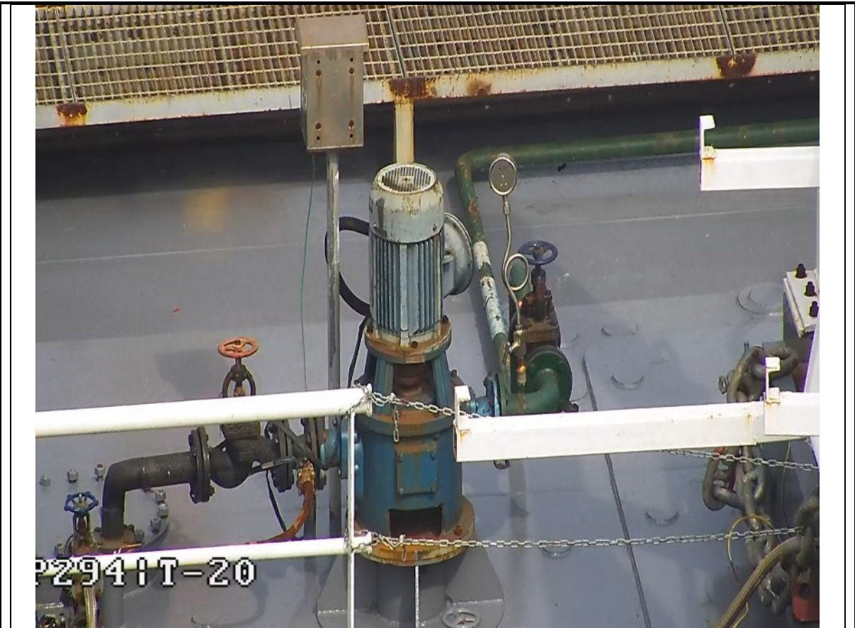
2#码头新增输油泵照片
