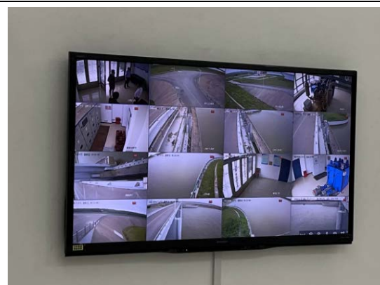
图 4.1-11 监控室监控画面
