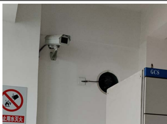
图 4.1-10 配电室监控系统
