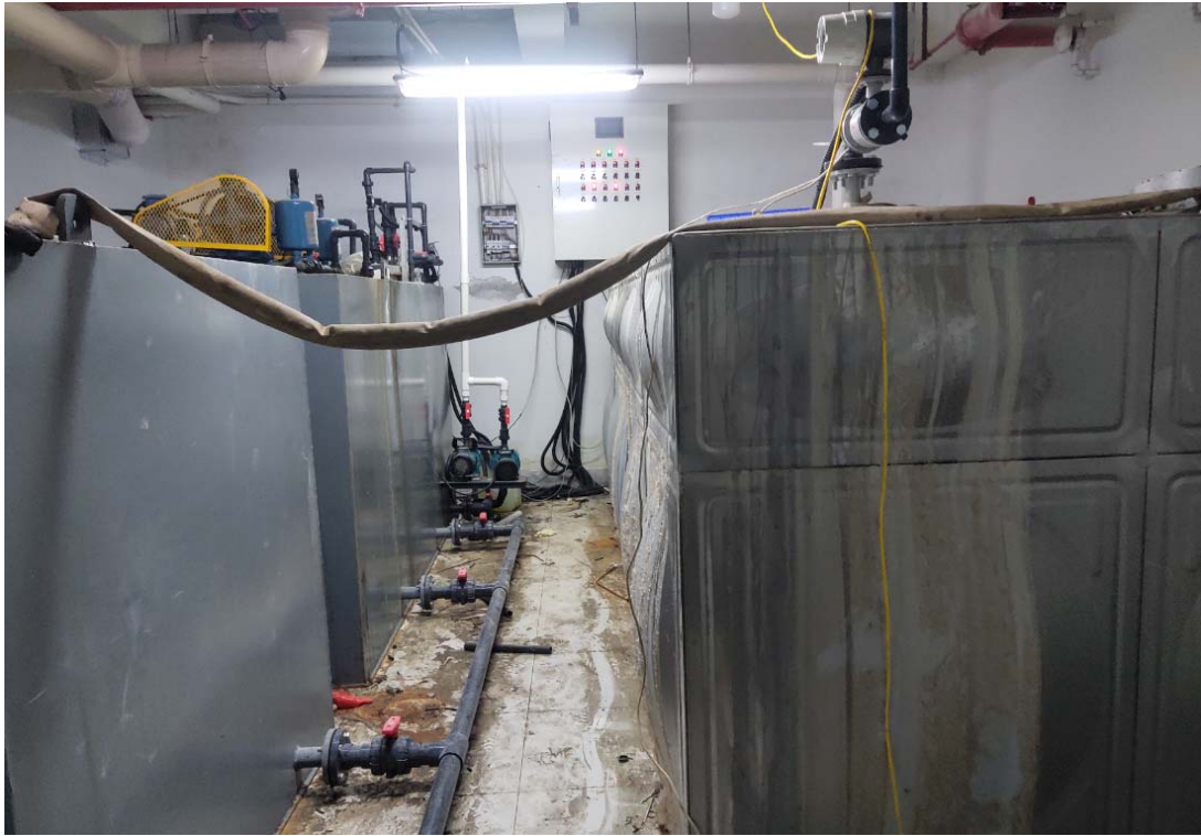
污水处理站现场照片
