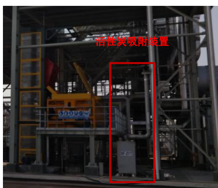
图 3.1-1 污泥混料区活性炭吸附装置
