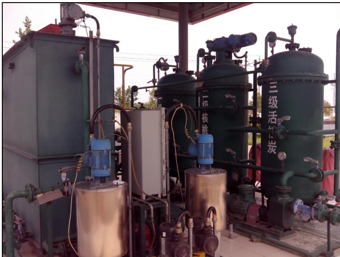
图 3.13-7 淮安齐湖油库含油污水处理设施（依托）
