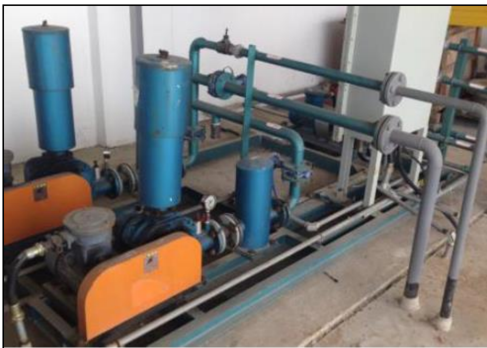
图 3.13-2 扬子玉带油库地埋式生活污水处理装置（依托）
