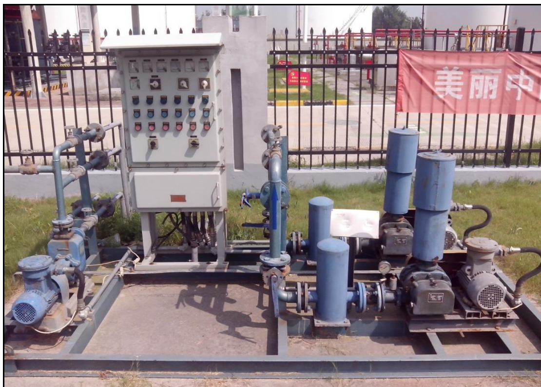
图 3.13-9 宿迁黑鱼汪油库生活污水处理设施（依托）
