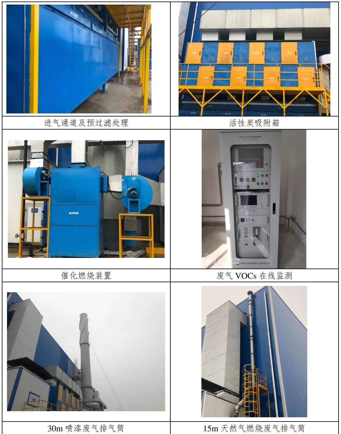
图 3-1 主要废气治理设施
